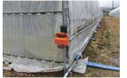
写真1 ハウス自動換気装置
